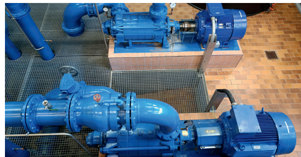
Pumpen fördern Grundwasser in die Speicherbehälter.
