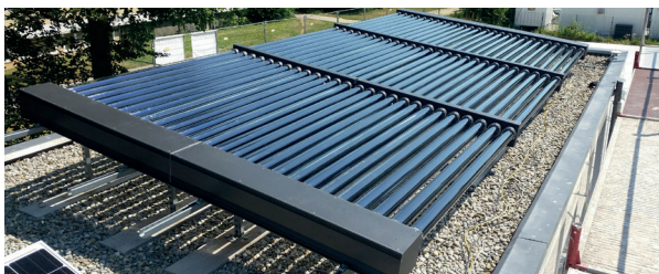
Die benötigte Prozesswärme wird mittels innovativer Vakuumröhren-Solarluftkollektoren bereitgestellt.
