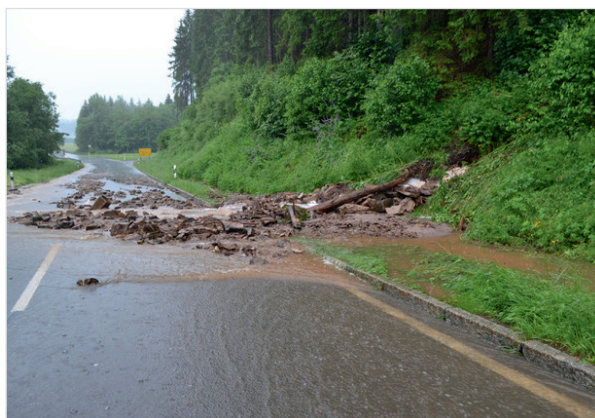
Blockierte Straße nach Starkregen
