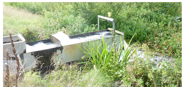
Künstliche Grundwasseranreicherung mit Spreewasser am Wasserwerk Briesen (Frankfurt Oder)
