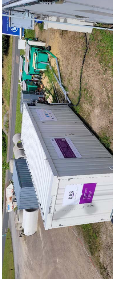
Pilotanlage zum Abbau von DMAc. Im Vordergrund: MBBR-Container, im Hintergrund: Vertikalfilteranlage (Quelle: Christian Koch, TU Dresden, Professur für Siedlungswasserwirtschaft)
