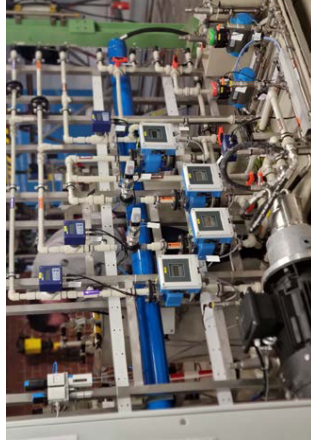
Hochdruckmembrananlage (Quelle: BWS)
