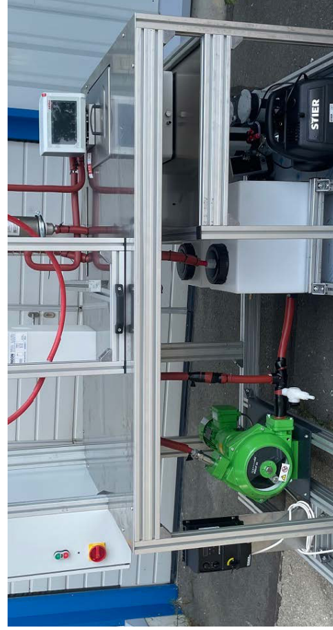
Membrane-seitiger Anlagenteil zur Erprobung der Verfahrenskombination aus keramischer Membrandestillation und Kristallisation (Quelle: Fraunhofer IKTS)
