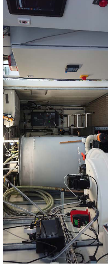
MBBR-Pilotanlage zum Abbau von DMAc (Quelle: Thomas Schalk, TU Dresden, Professur für Siedlungswasserwirtschaft)
