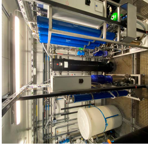
Pilotierungsanlage in mobilem Container (Quelle: UDE)
