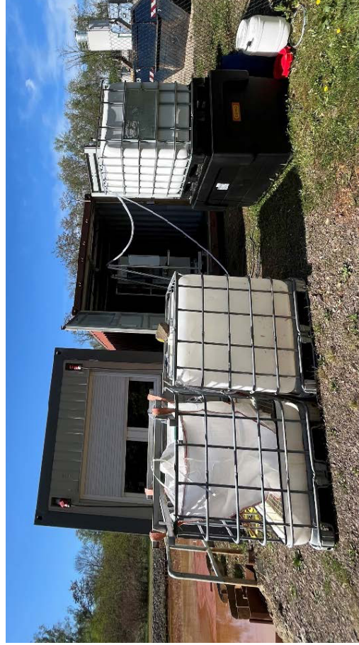
Installierte SULFAMOS-Pilotanlage am Feldstandort einer Wasserbehandlungsanlage. Rechts: Modul zur vorwärtosmotischen Sulfatreichung, links: Modul zur Sulfatabtrennung mittels Fällung als Gips (Quelle: G.E.O.S.)
