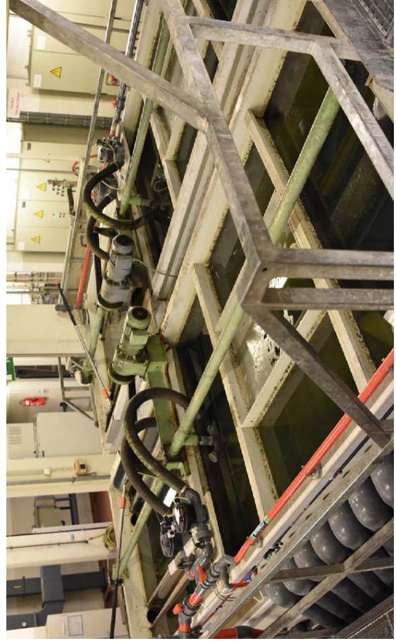
Anlage VW: Aktuelle Abwasserreinigungsanlage im VW-Werk in Braunschweig (Quelle: VW-Werk Braunschweig)
