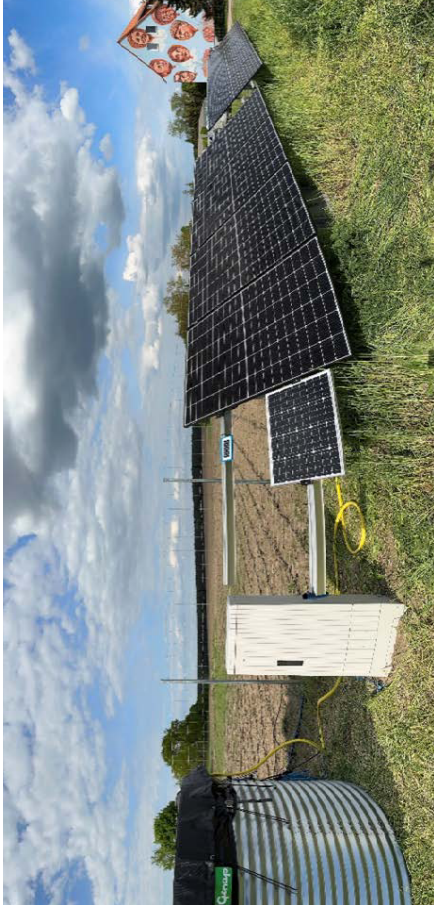
Bewässerungssystem am Reallaborstandort in Brandenburg (Quelle: Umweltbundesamt)
