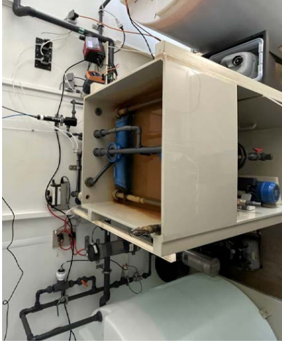
Pilotanlage mit keramischem Membranmodul (Flachmembranen, 6 m 2 Membranfläche) in Filtrationstank (mitte), Feedvorlage mit Filterspülwasser (rechts) und Filtratank (links) (Quelle: ZVGW-TUHH und CERAFILTEC)
