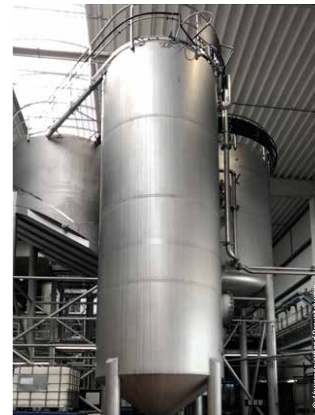
Abb. 2: Großtechnische Struvit-Anlage auf der Kläranlage Braunschweig.
